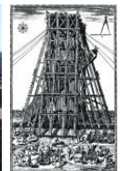
Подъем и установка колонны обелиска Сигизмунда, на пл. Святого Петра в Риме, 1586 год
