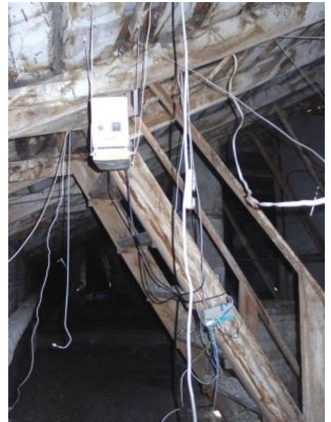
Феерическая расстановка оборудования на чердаке
