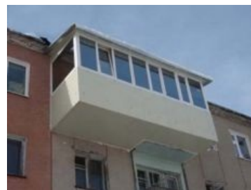
Балкон быдла, пораженный раком (терминальная стадия).
